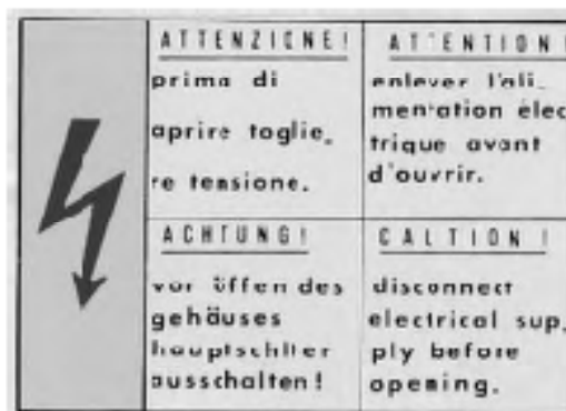
Табличка, предупреждающая об опасности поражения электрическим током - рядом с главным выключателем
